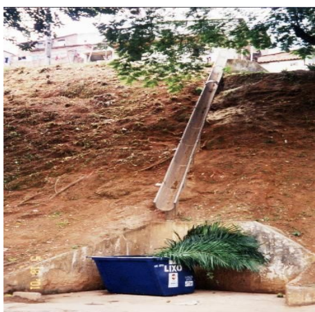
Figura 28 - Lixoduto em áreas de difícil acesso
