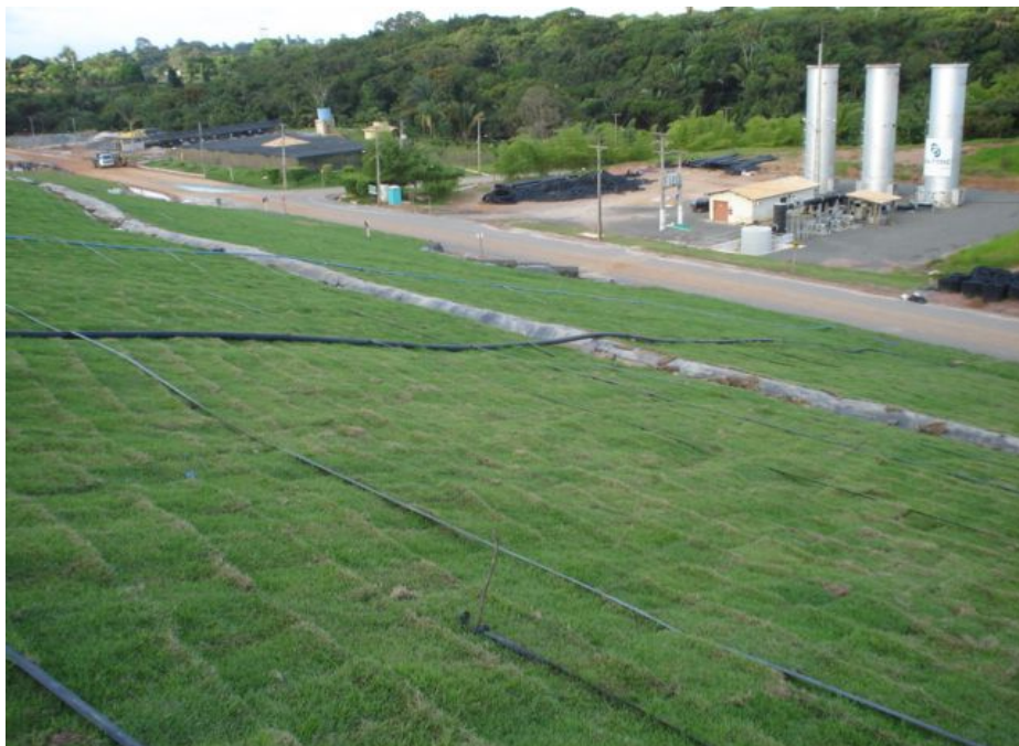
Figura 41 - Vista da central de tratamento de gás
